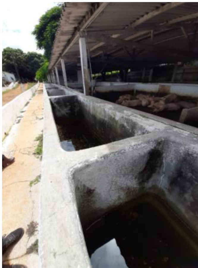
Figura 5.9: Tanques de reservação de água de chuva.
