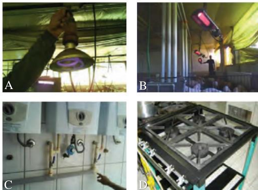
Figura 5.20: Uso do biogás na forma na queima e geração de energia térmica: aquecimento de creches (A e B) e utilização do gás em cozinha (B e C).
