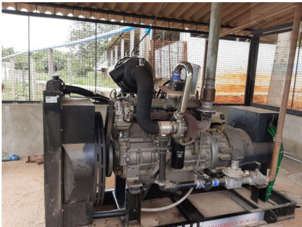
Figura 5.6: Gerador de energia a biogás.
