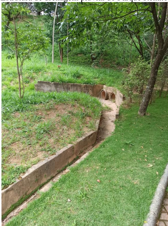
Figura 5.20 – Estrutura de drenagem pluvial do Parque Renato Azeredo Neto.
