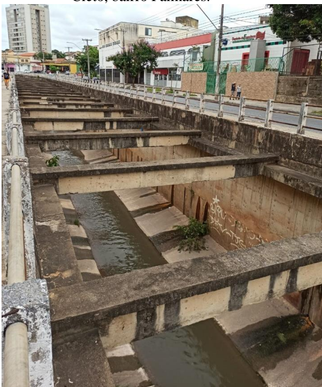
Figura 5.13 – Córrego Cachoeirinha, trecho entre Rua Coronel Jairo Pereira e Avenida José Cleto, bairro Palmares.
