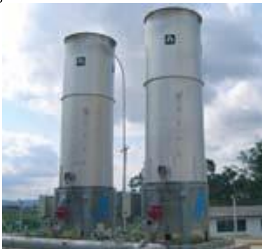
Figura 7 - Flare enclausurado em aterro sanitário
