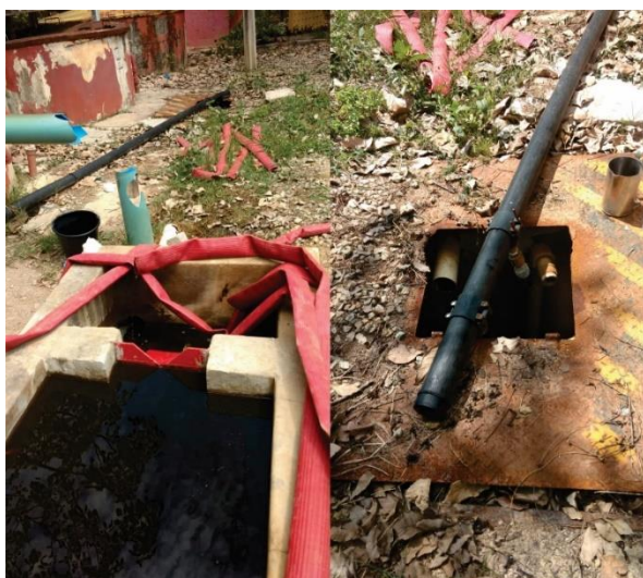
Figura 20 - Vertedouro e tanques de líquido percolado da CTRS BR040
