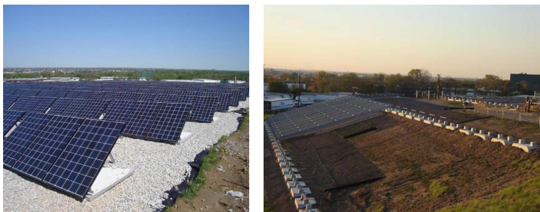
Figura 10 - Instalações solares no aterro Pennsauken
