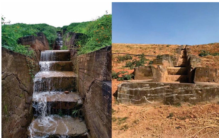
Figura 19 - Sistema de Drenagem danificados na CTRS BR040
