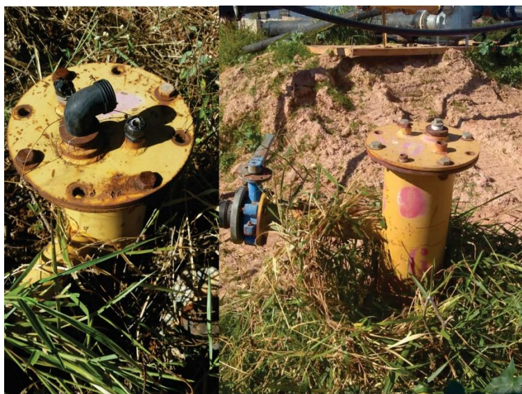
Figura 21 - Poços de gás danificados da CTRS BR040
