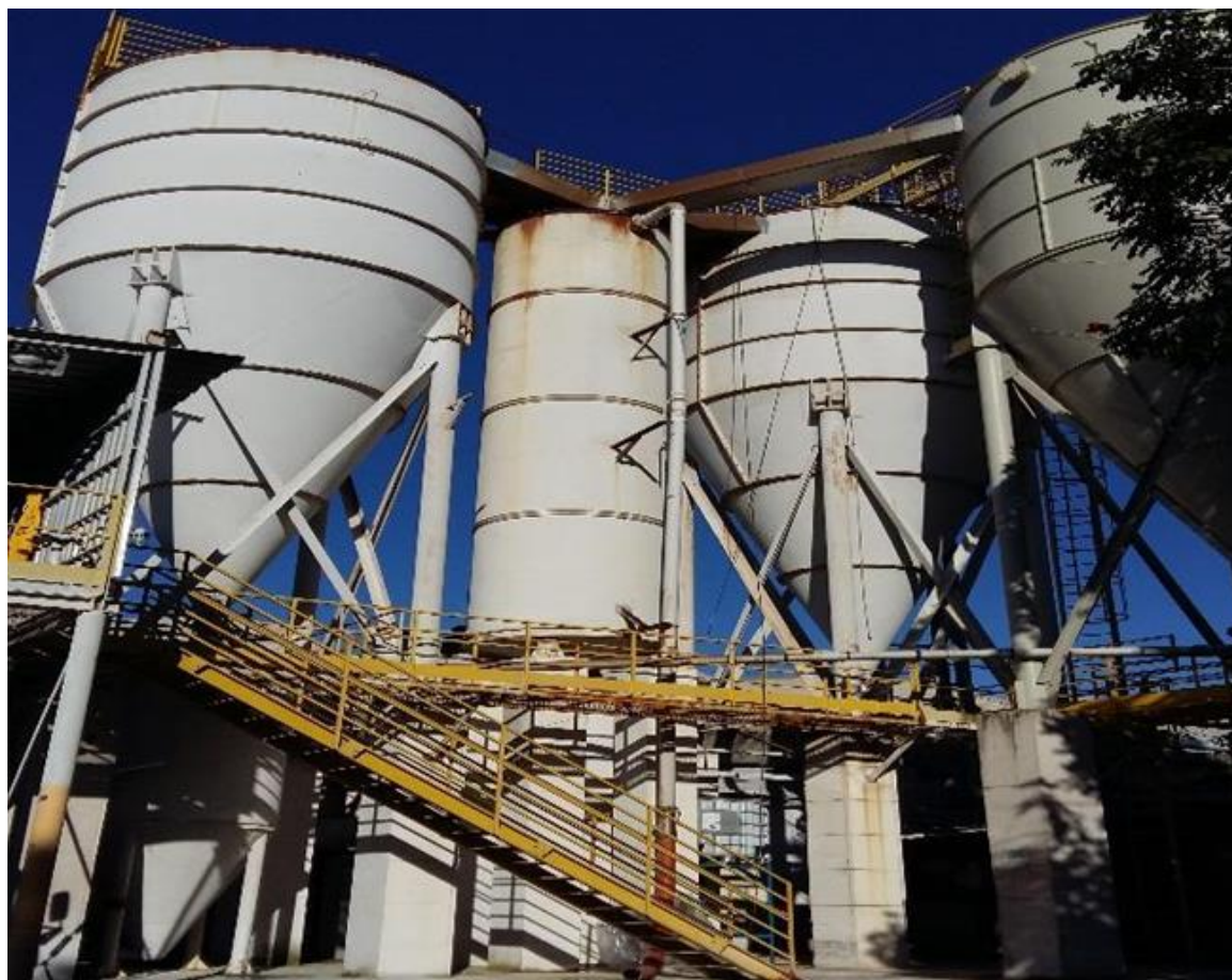
Figura 6 – Estação de Tratamento de Efluentes Industriais (ETEI-II)
