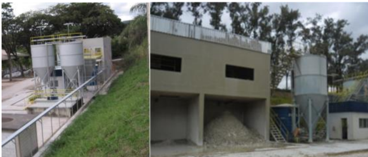
Figura 4 – Estação de Tratamento de Efluentes Industriais (ETEI – I)
