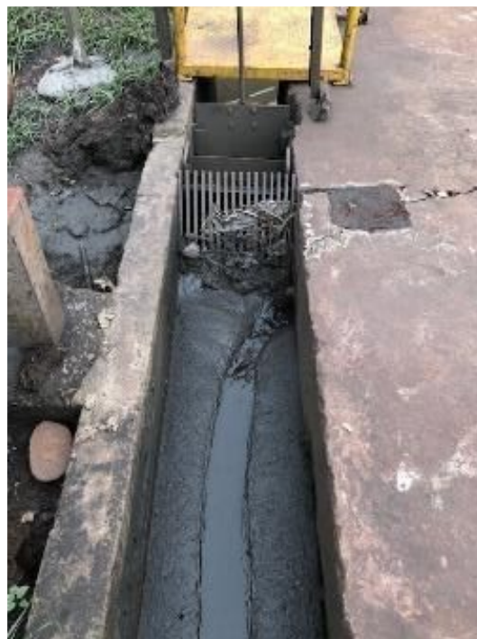
Figura 5: Canaleta obstruída com manganês
