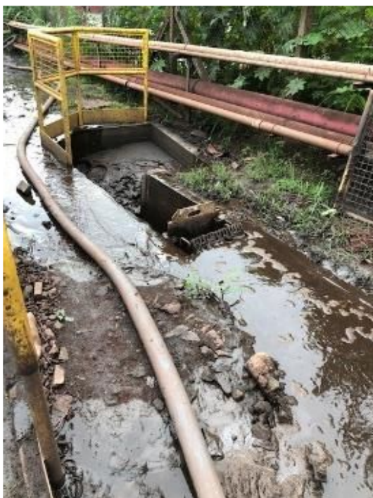
Figura 4: Canaleta obstruída que deveria interligar o efluente à ETEI
