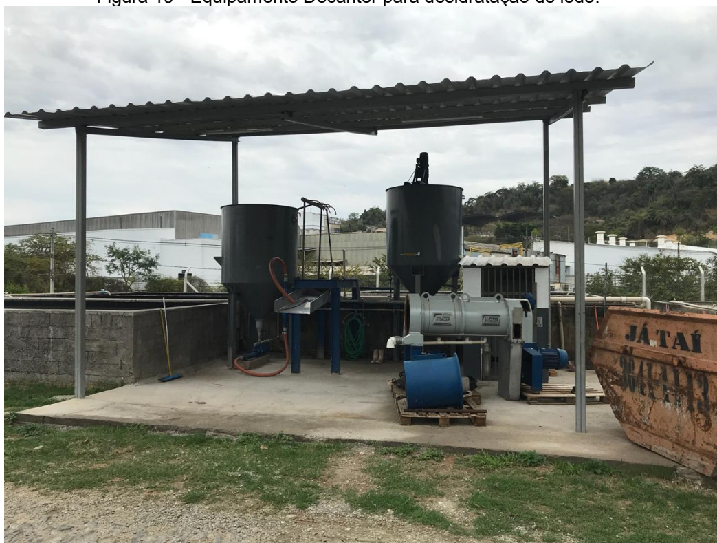
Figura 19 - Equipamento Decanter para desidratação de lodo.
