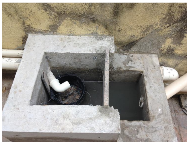
Figura 6: Caixa de gordura com a peneira
