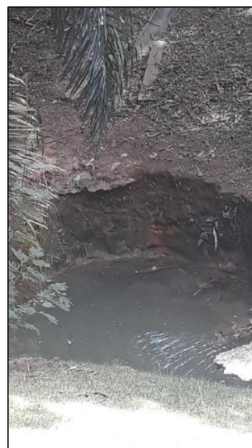
Figura 12 Detalhe da erosão lateral observada.
