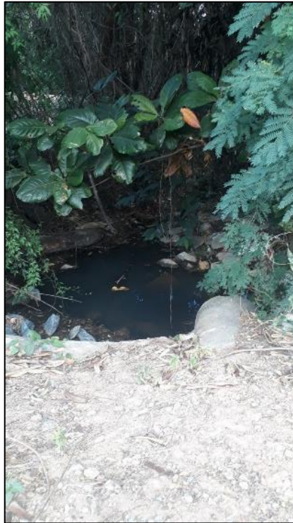
Figura 34 Segunda tubulação com saída no mesmo ponto da Figura 32.
