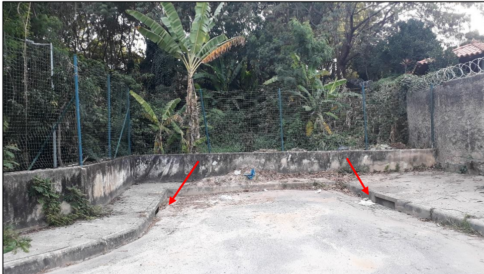
Figura 35 Vista do final da Rua Evangelista Ferreira Diniz com identificação de duas bocas de lobo.
