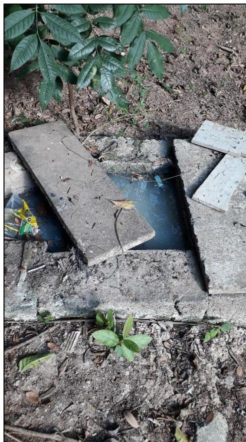
Figura 24 Detalhe da caixa de passagem da figura anterior.
