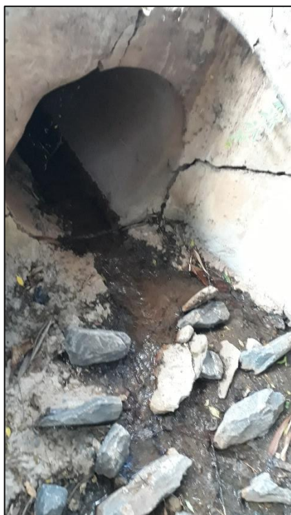
Figura 32 Saída de tubulação.
