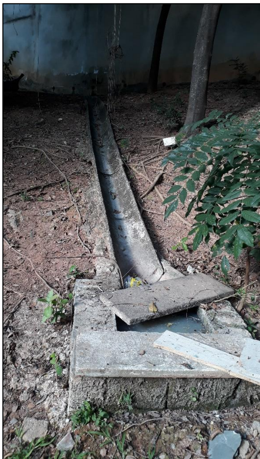
Figura 23 Vista de uma caixa de passagem.
