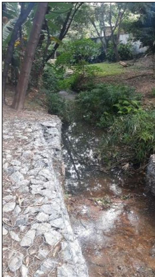
Figura 20 Ponto de lançamento do fluxo advindo da caixa coletora da Figura 19.
