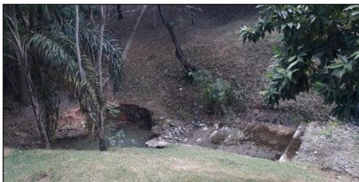
Figura 11 Erosão lateral da margem direita.
