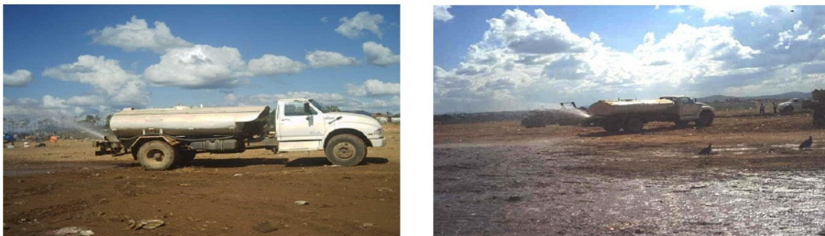
Figura 19 - Aspersão de água na frente de serviços do Aterro Sanitário de Belo Horizonte
