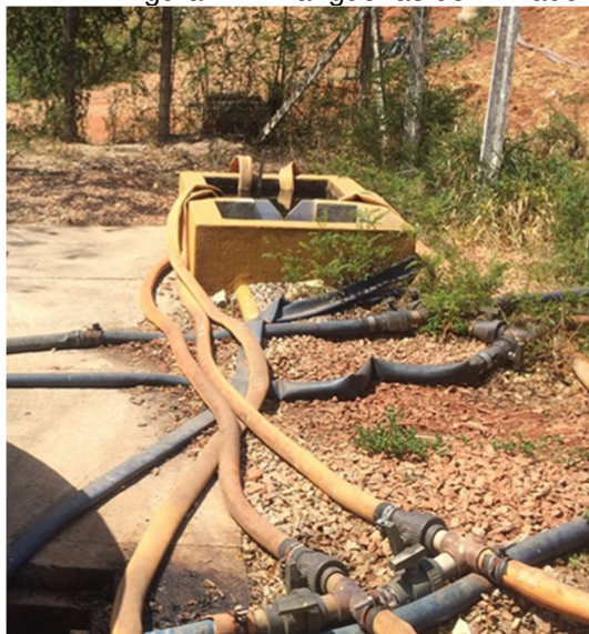
Figura 12 - Mangueiras de lixiviado
