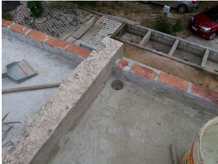
Figura 32 - Orifícios feitos na laje
