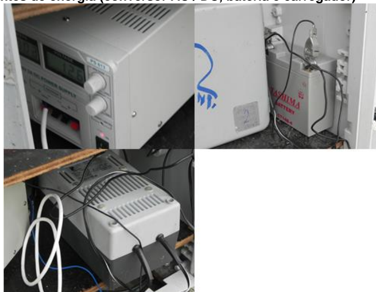
Figura 12 - Fontes de energia (conversor AC / DC, bateria e carregador)
